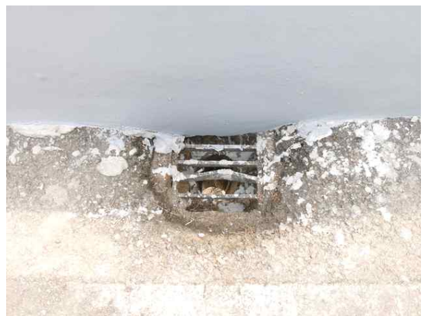
배수시설 S1 막힘 보수
